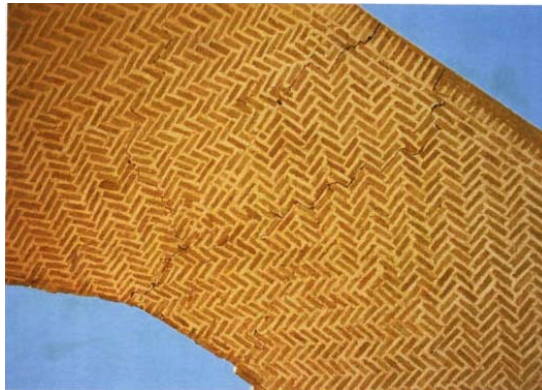
تصویر ۲۱ تزیینات خفته راسته آجری در زیر طاق این بنا (غلامی اسفهرود، ۱۳۸۳)
