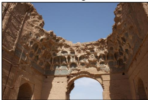
تصویر ۷۱: مقرنس‌های آجری ایوان شرقی (مأخذ: آرشیو تصاویر اداره میراث فرهنگی شهرستان خواف)
