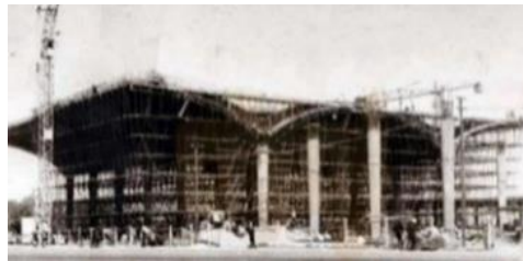
تصویر ۱۱: عکس قدیمی از ایستگاه راه‌آهن مشهد در حال ساخت (مأخذ: URL 2)
