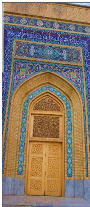
تصویر ۶: درِ چوبی مدرسه و تزیینات سردر در جبهه شمالی مدرسه خیرات خان (مأخذ: نگارنده)
